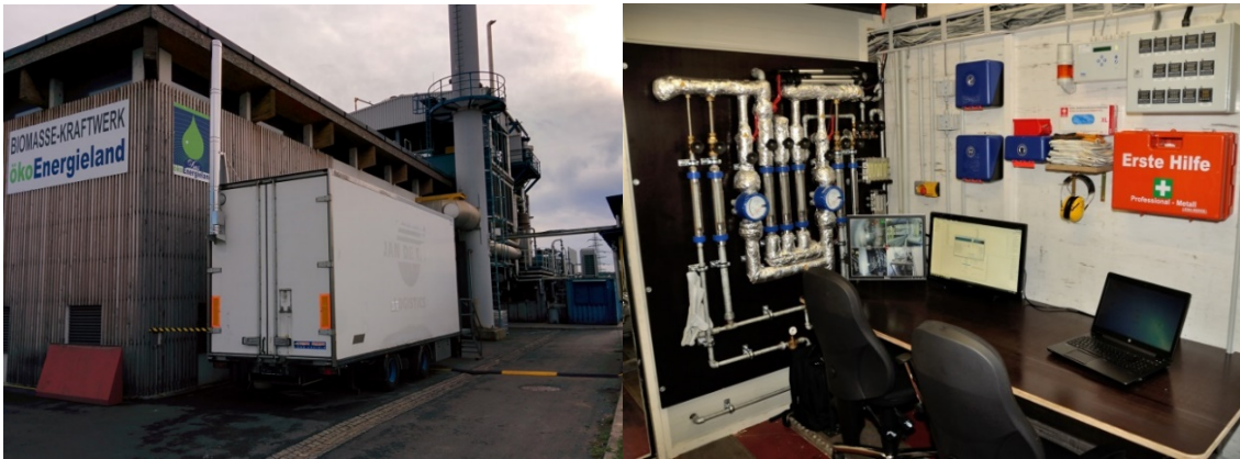
Abbildung 2: mobile TSA Anlage [4]
