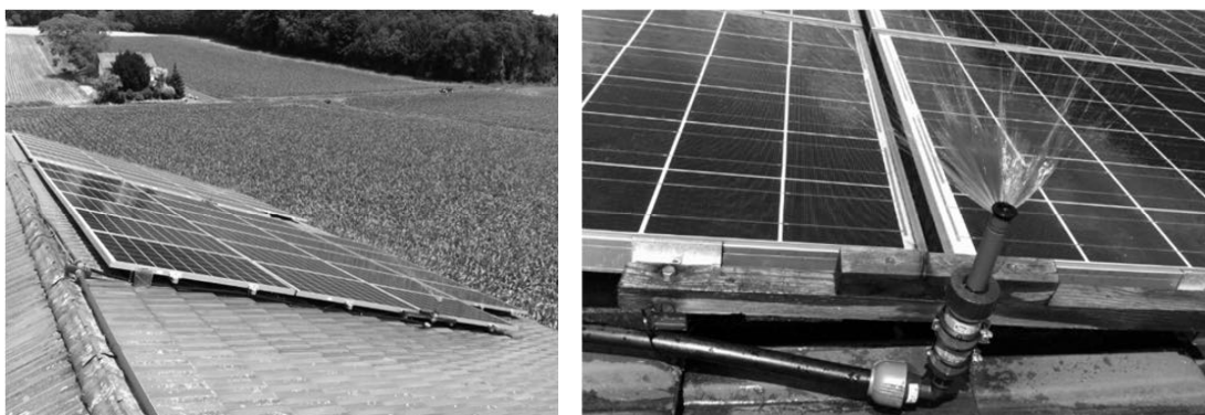
Abbildung 1: Ansicht beider Anlagen im Kühlbetrieb (links), Detailansicht einer Sprühdüse im Kühlbetrieb (rechts)
