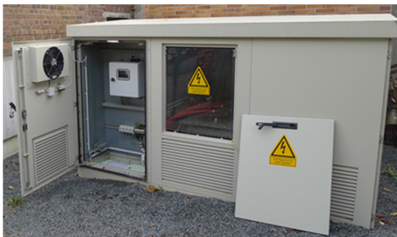
Abbildung 1: Frontansicht der Kompaktstation NDV 1600 mit eingebautem ERT
