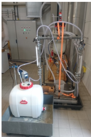
Abb. 2: Pilotanlage zur Gülle Aufarbeitung
