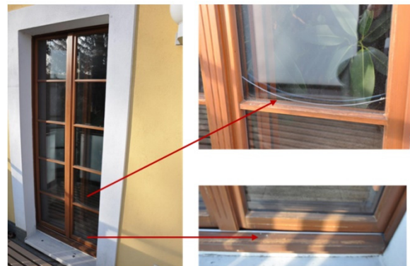
Abbildung 4: Kastenfenstertür Südseite ohne Verschattung, Riss in der äußeren Scheibe der außenliegenden WSV, Farbablplatzungen der Dickbeschichtung [Conrad]
