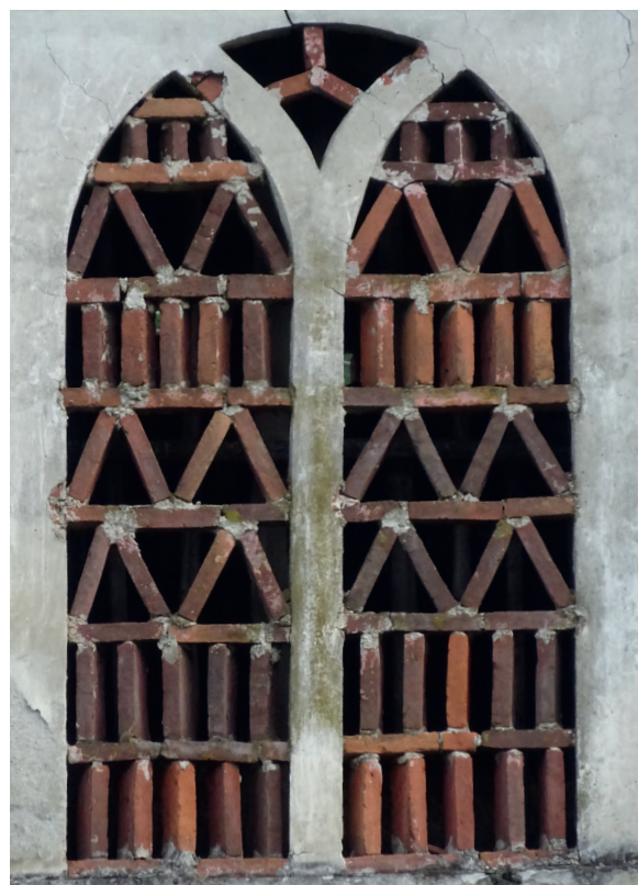
Abb. 247 Eines der Lüftungsfenster des Ziegelgitters in Murau . Es scheint, dass die hochgestellten Ziegel etwas verdreht aufgestellt wurden, wodurch wohl auch weniger oft bei Schlagregen Wasser ins Gebäudeinnere gelangte.
