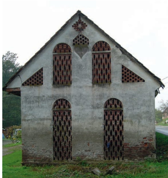
Abb. 144 Die Ziegelgitter dieser Giebelwand eines Gebäudes in Mellach in der Waldstraße wurden unter Verwendung von einfachen frühen Hochlochziegeln gemauert. Das Gitter setzt sich aus vier Rundbogenöffnungen mit Gitterausfachungen, die Doppelpfeile formen, und zwei Dreieckgitterfeldern auf den Seiten sowie einem Gitter in Form einer Monstranz unter dem First zusammen. Durch die Verwendung von Hochlochziegeln wirkt die Monstranz relativ feingliedrig. Alle Gitter blieben unverputzt. Unter der Basis der Monstranz wurde eine herzförmige Fläche auf den Verputz der Giebelfassade aufgetragen, in der die Jahreszahl 1896 der Errichtung und die Initialbuchstaben der einstigen Erbauer mit F.M.P. angegeben werden. Bei der Herzdarstellung dürfte es sich wieder um das Herz Jesu handeln. Herz und Monstranz dürfen als Abwehrelemente des Gitters interpretiert werden. Foto: Doris Schrötter 2004
