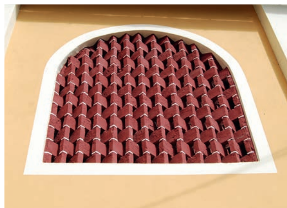
Abb. 270 Eines der Gitter mit sogenannten "Schrenkmaiern" an der Stallscheune in Thann bei Maria Buch-Feistritz . Die unter 45^\circ zur Fassadenrichtung in der Maueröffnung verdreht aufgestellten Gitterziegel sitzen jeweils an drei Punkten auf den nächstunteren, die um 90^\circ zu diesen verdreht aufgestellt sind. So entsteht ein räumliches konstruktives Gittergefüge, das relativ stabil ist und den Regen gut abhalten kann. Foto: 2018
