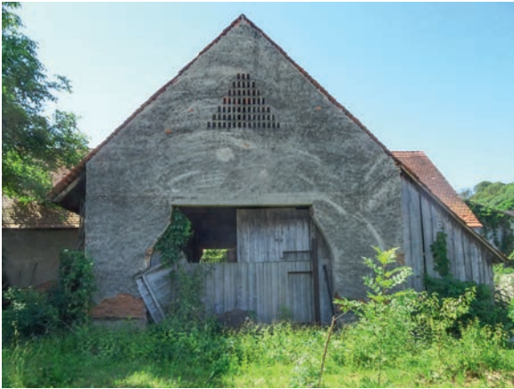
Abb. 11 Das sehr einfache Ziegelgitter wurde an dem Wirtschaftsgebäude in Graz-Straßgang in der Gradner-Straße 194 aus dem Jahr 1932 auf der Nordseite eingebaut, um das einst dort eingelagerte Heu trocken zu halten. Das Gitter besteht aus gleichförmigen stehendformatigen rechteckigen Lüftungsöffnungen neben- und übereinander. Das Gitter besteht aus horizontalen und vertikalen gemauerten Stegen und wurde relativ sorgfältig mit der Fassade als tragendes Gitter mitgebaut und mitverputzt. Es wurde an der Wetterseite des Objektes eingebaut und bot hier einen gewissen Schutz gegen eine Durchfeuchtung des Heus bei Regen. Die Durchfahrt unterhalb wurde sekundär aufgeweitet, als breitere Landwirtschaftsmaschinen gebraucht wurden. Foto: 2020
