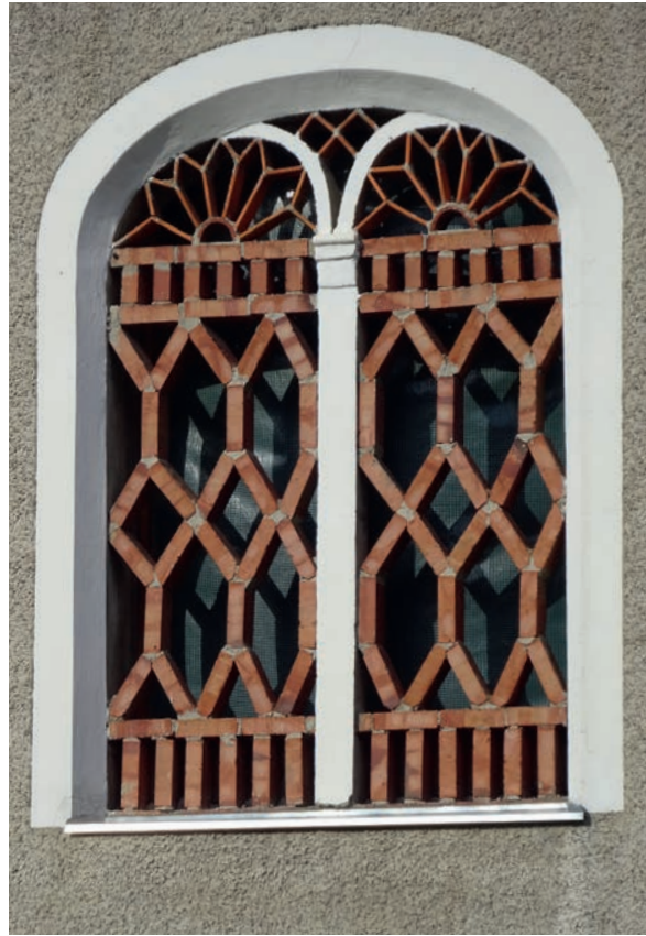
Abb. 215 Man sieht im Detailfoto, dass die neuen Ziegel des Gitters in Mautern nicht sehr weit in die Laibung nach hinten reichen, sodass mehr Licht in den Innenraum kommt und Fenster dahinter eventuelle sogar in der vorhandenen Laibung untergebracht werden können. Foto: Adele Drexler 2020
