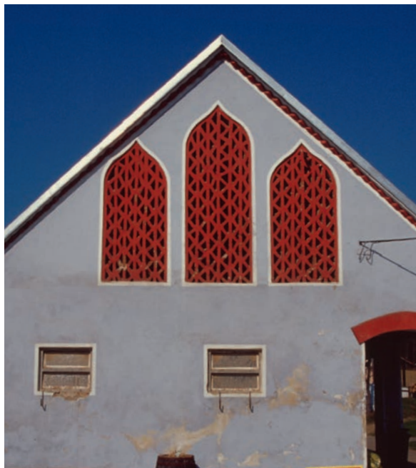
Abb. 175 Diese spätgotisch geformten Maueröffnungen mit ihrer Ziegelgitterausfachung in einer kleinen Stallscheune in Fladnitz an der Raab, Nr 11, gehen, wie vieles in der Gotik, auf islamische Vorbilder zurück. Die Mauerdurchfeuchtungen im Erdgeschoss haben inzwischen leider zu einer Verbretterung der unteren Fassade bis unmittelbar zur Unterkante der Gitter geführt. Daher wird hier ein früheres Foto verwendet. Die Gitter bestehen aus jeweils sechs vertikalen Streifen mit jeweils einem Zickzackmuster. Das Gitter tritt etwas gegenüber der Fassade zurück. Fassade und Gitter wurden glatt verputzt. Um die drei Ziegelgitter wurde jeweils eine schlanke aufgemalte weiße Fasche geführt. Die Gitter sind außen kräftig rot eingefärbt. Foto: 2002
