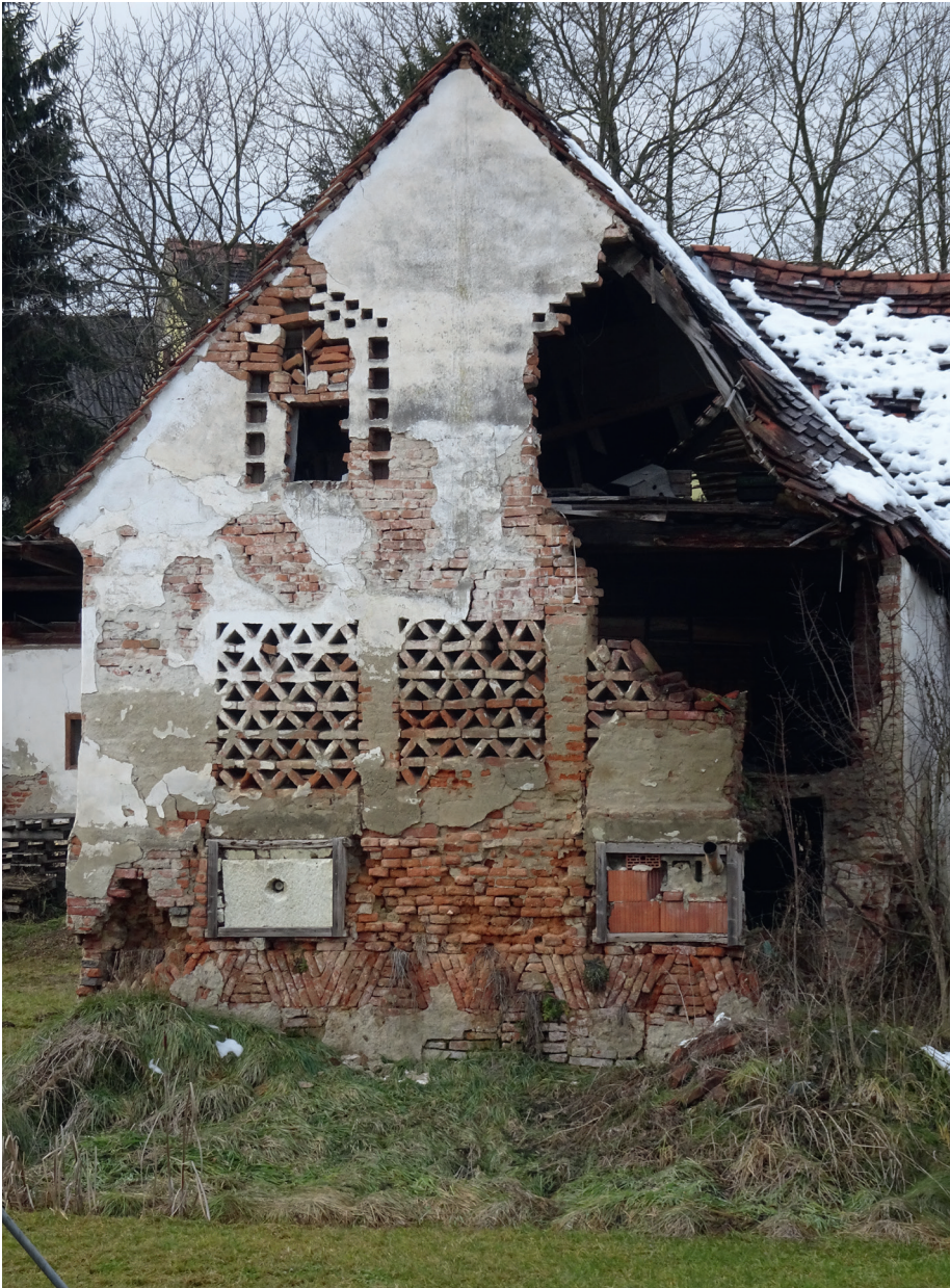
Abb. 331 Dieses Objekt steht in Zöbing an der Raab Nr. 5 unmittelbar an der Schnellstraße 68. Die Vermorschung des Dachstuhles führte hier offenbar zum Teileinsturz des Daches und der südöstlichen Giebelwand. Dabei stürzten auch Teile von Ziegelgittern ab. Foto: 2021
