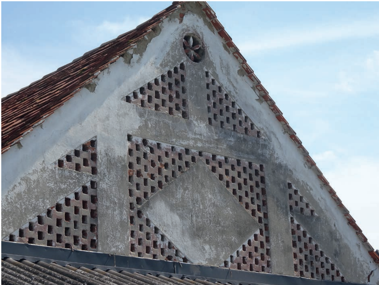
Abb. 50 Der sehr kleine Bau in St. Ulrich am Waasen in Glaueregg Nr. 20 besteht aus zwei seitlichen tragenden dreieckigen Gitterflächen, einem Gitterfeld mit "Schrenkmaiern" in der Mitte, das ebenfalls tragend ist und während des Mauerns in die Wand eingefügt wurde, und aus einem Kreuz unter dem First, das aus einzelnen tragenden Lüftungsöffnungen besteht. Unterhalb im Erdgeschoss war ein kleiner Stall untergebracht. Foto: 2021
