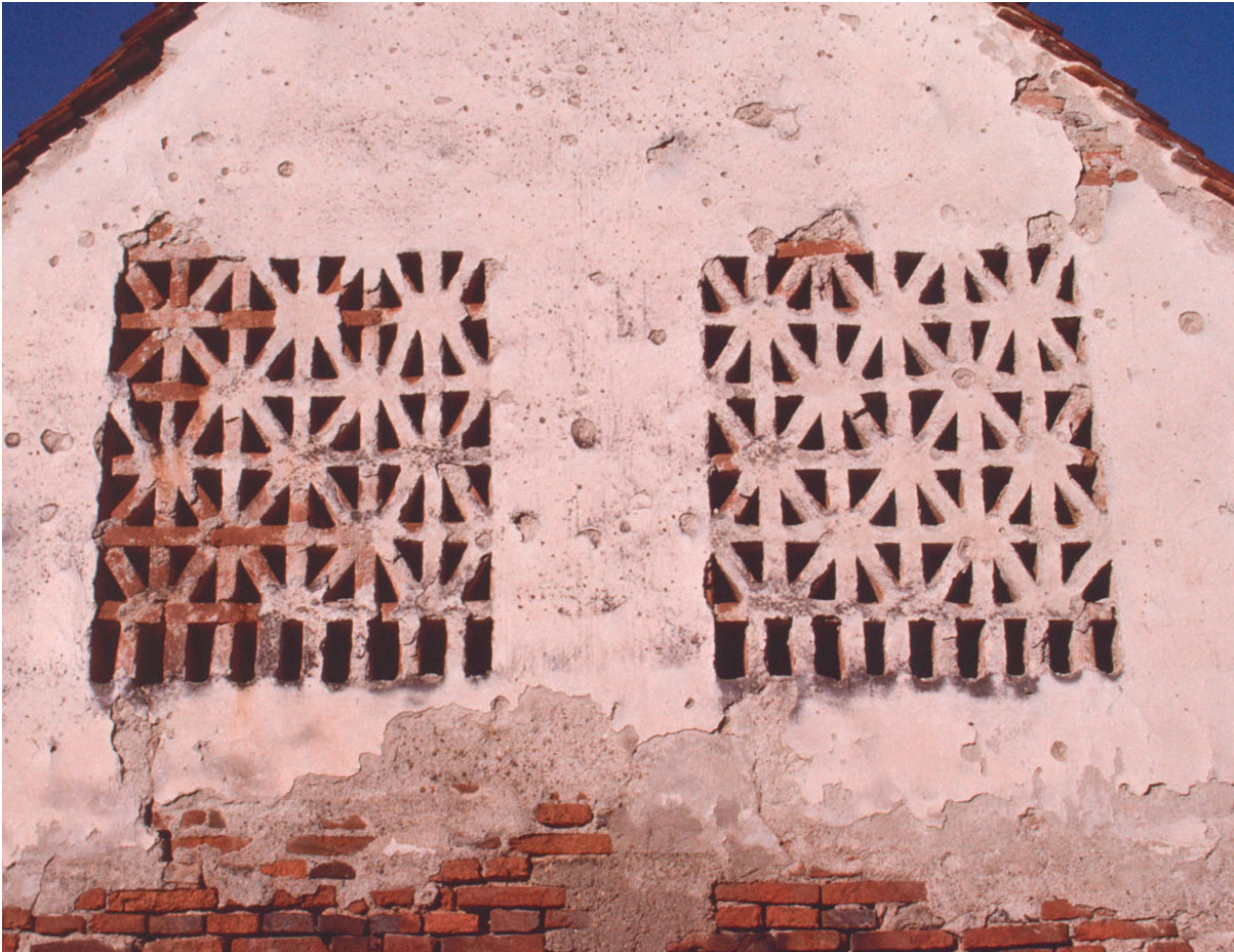
Abb. 61 Zwei etwa quadratische tragende Ziegelgitter in einem Giebel in Ungerdorf bei Gleisdorf wirken wie eine schlichte textile Decke mit Fransen entlang der unteren Kante. Das Gitter wurde verputzt und in der Farbe der Fassade mitgefärbt. Foto: 1993
