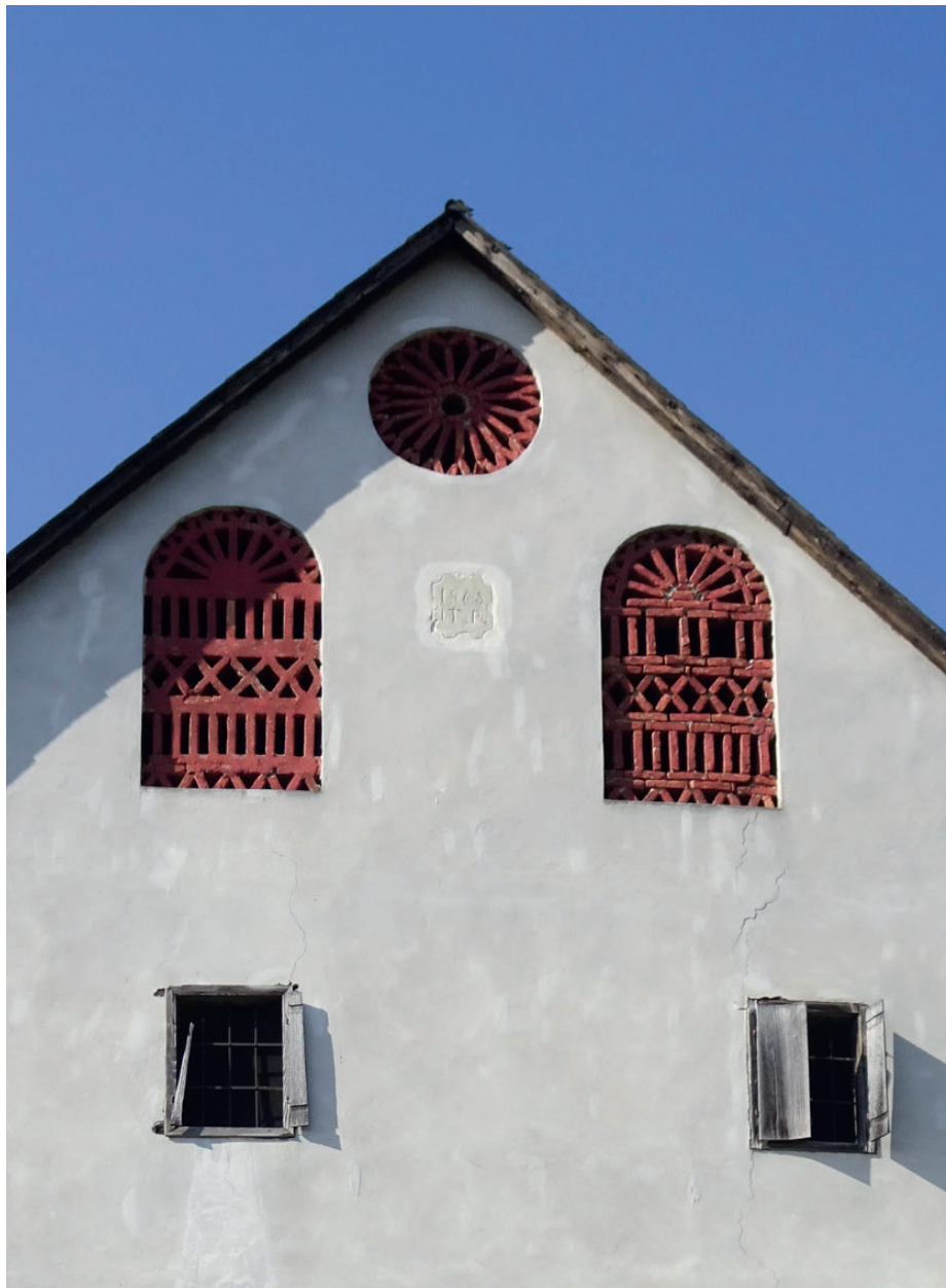
Abb. 257 Das Wirtschaftsgebäude in Pitschgau , Pollanzweg 17, wurde in der Zwischenzeit sukzessive saniert. Die Informationskartusche ist wieder lesbar. Warum im rechten Ziegelgitter heute zwei Ziegel und der Verputz fehlen, konnte nicht geklärt werden. Foto: 2022
