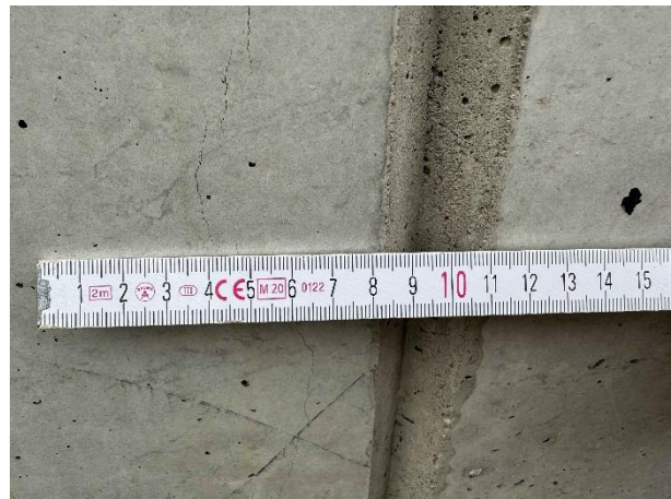
Abbildung 8 Rissbildung neben vertikalen Sollrissfuge
