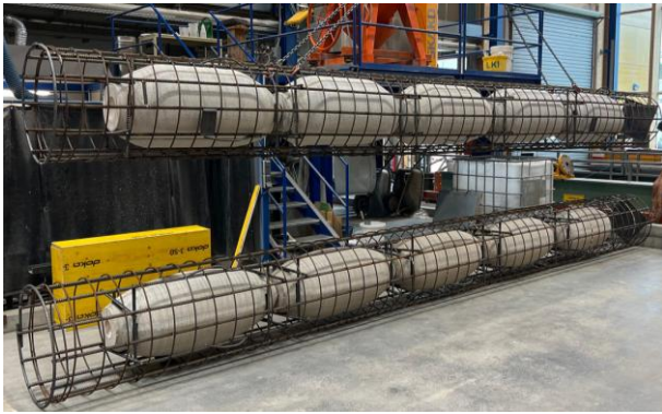
Abbildung 9 Bewehrungskörbe mit integrierten Aussparungskörpern
