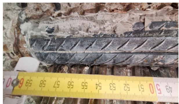
Abbildung 9 Freigelegte Einzeldrähte innerhalb einer Sondierungsöffnung, die keine visuellen Auffälligkeiten zeigen.
